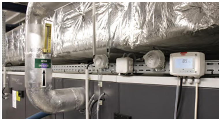
CP210-R dans le local de traitement d'air d'une infrastructure industrielle.
